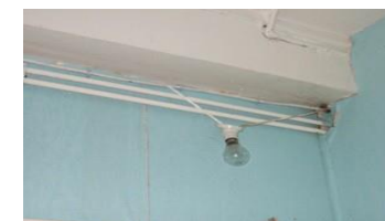
Éclairage insuffisant et dangereux
