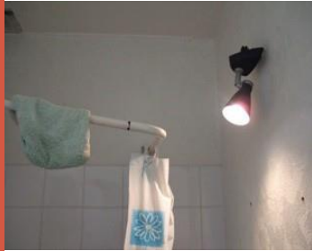
Branchement électrique dangereux
