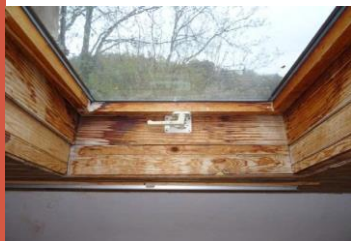
Absence de protection contre les infiltrations d'eau
