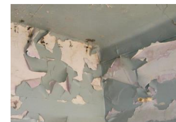
Peinture écaillée contenant du plomb
