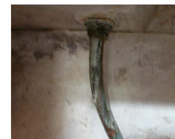
Absence de siphon
