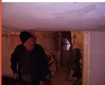
Hauteur sous plafond insuffisante
