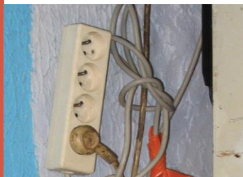
Installation électrique dangereuse
