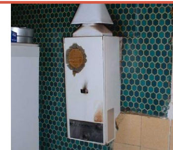
Absence de dispositif d'évacuation des gaz brûlés
