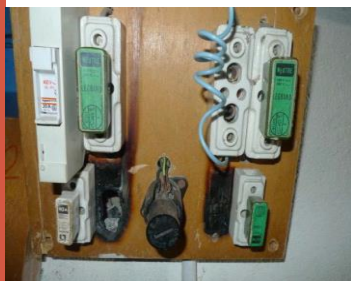
Branchements d'électricité vétustes
